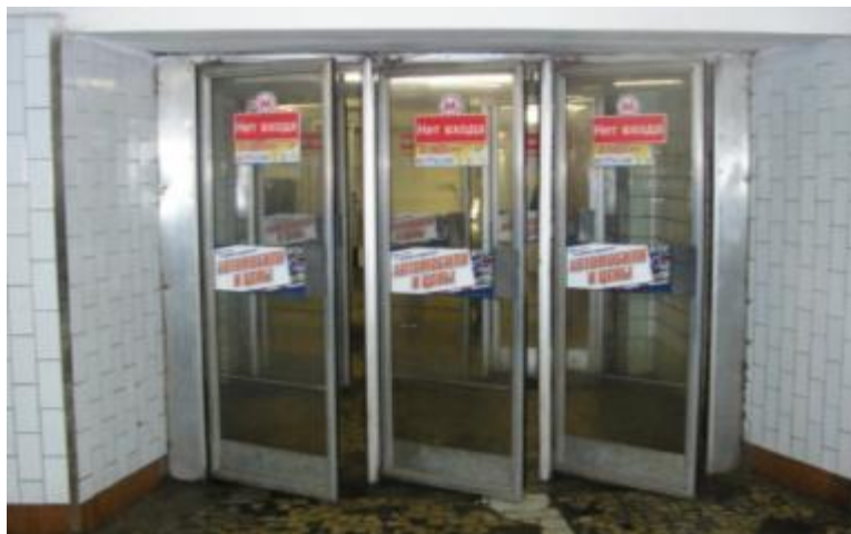
стикеры на входных дверях вестибюлей станций
